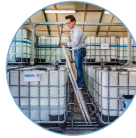
Blue Battery, Delft LOKALE ENERGIEOPSLAG
